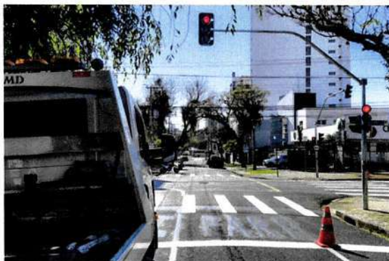
Novo semáforo instalado no cruzamento da Rua Brigadeiro Franco com Al. Princesa Izabel. Curitiba, 17/08/2023. Foto: Pedro Ribas/SMCS
