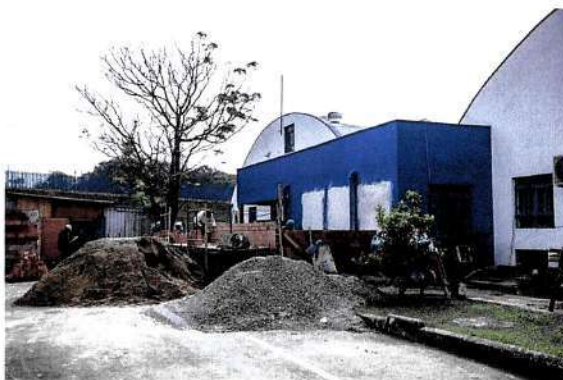
Obra de reforma e ampliação no Centro de Formação e Desenvolvimento Profissional da Guarda Municipal de Curitiba, na CIC. Curitiba, 21/06/2023. Foto: Hully Paiva/SMCS
