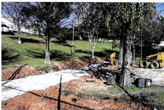
Obras de recapeamento da pista de caminhada da Praça Zumbi dos Palmares. Curitiba, ago./23. Foto: Levy Ferreira/SMCS
