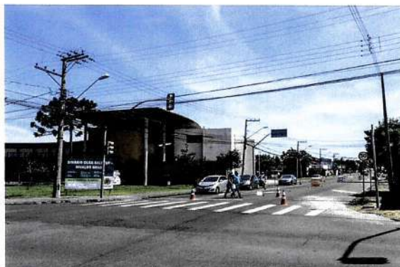
Iniciam as obras do binário Olga Balster e Nivaldo Braga do bairro Cajuru. Curitiba, Foto: Hully Paiva/SMCS
