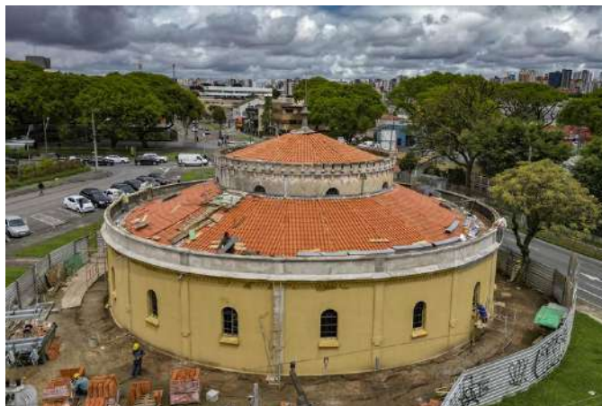
Obras de reforma e manutenção do Teatro Paiol. - Curitiba, 03/11/2022 - Foto: Daniel Castellano
