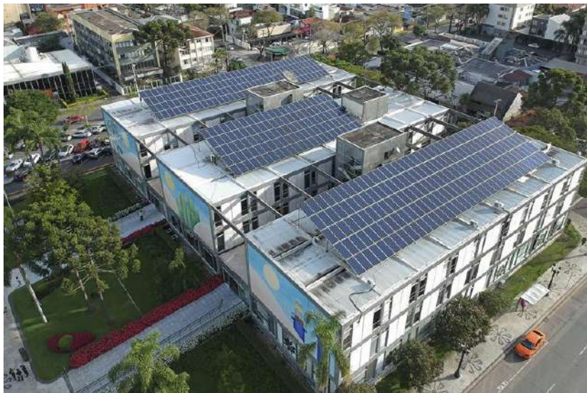
Painéis solares instalados no telhado do Palácio 29 de Março, sede da Prefeitura de Curitiba. Foto: Luiz Costa /SMCS
