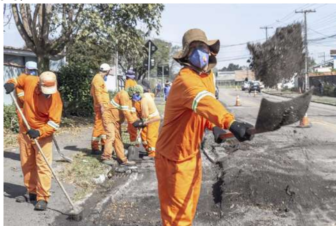
Obras de fresa e recape da Rua Napoleão Manosso, esquina com Rua Luiz Boza em Santa Felicidade. Curitiba, 8/07/2022. Foto Ricardo Maraió/SMCS
