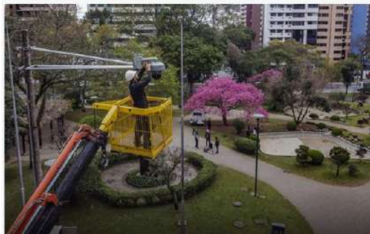
Instalação de câmeras de segurança na Praça do Japão. Curitiba, 13/07/2022. Foto: Daniel Castellano / SMCS
